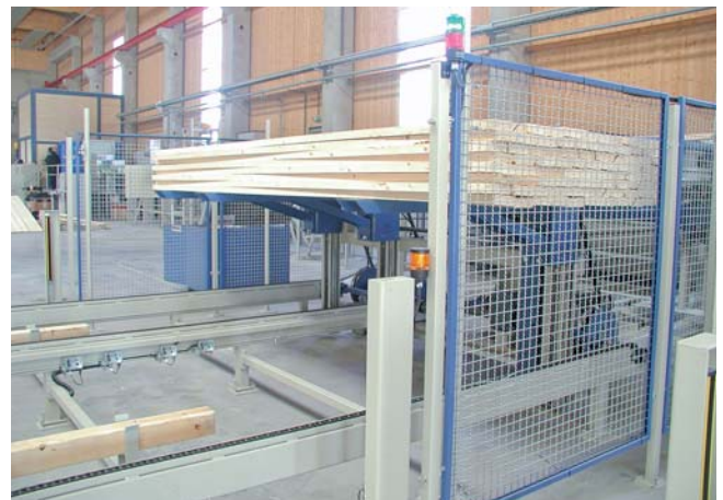
Stapelautomat für Schnittholz mit Lagenversatzeinrichtung zur Stabilisierung des Schnittholzpaketes
